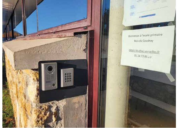
▲ Mise en place d'un interphone caméra avec 3 postes dans les bureaux des professeurs des écoles, dans le cadre de la sécurisation des écoles : 6 400 €
